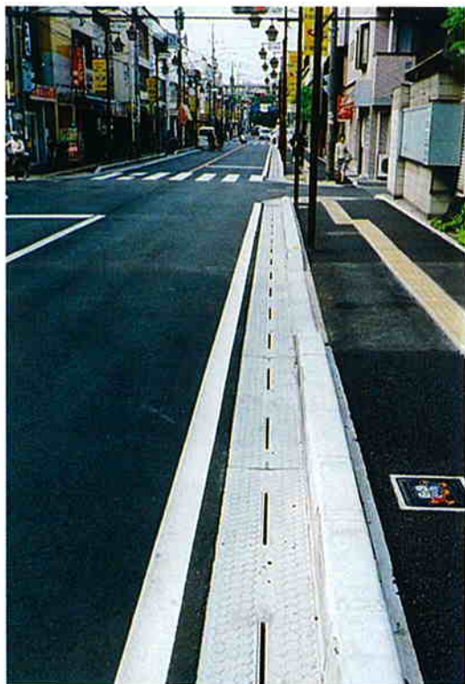
▲ バリアフリー安全対策工事に採用
