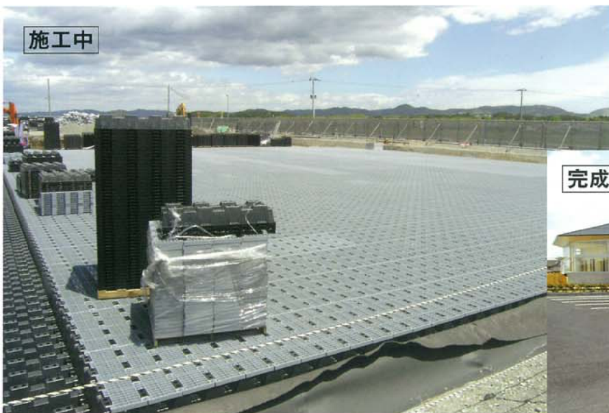
宮城県内庁舎調整池 (貯水量: 1,700m 3 )
