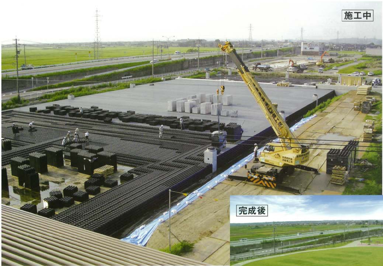
石川県内区画整理調整池 (貯水量: 9,200m 3 )
